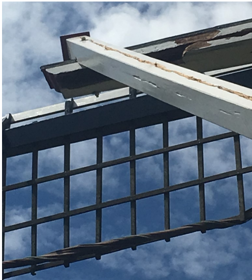
In de schoren waren de scheuren zo breed en diep, dat er een complete cultuur aan plantjes in kon gaan groeien. (foto Jan Tielemans)
