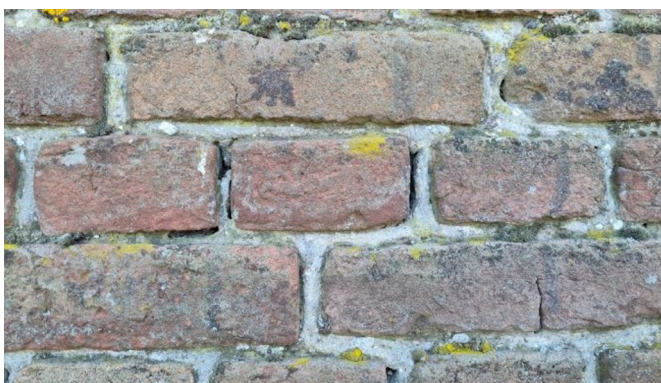
Slecht uitgevoerd voegwerk, dat duidelijk aan enig onderhoud toe is.
