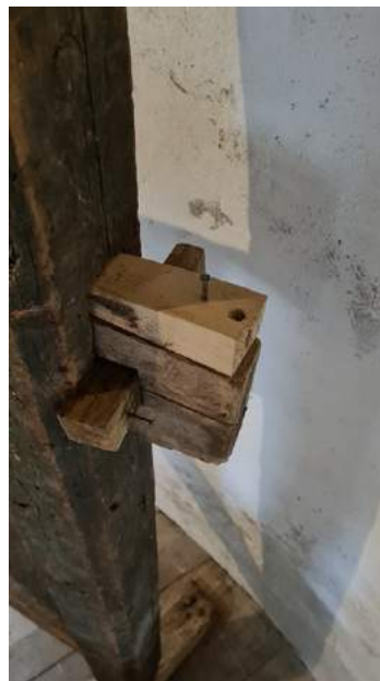
Een nieuwe spie aan de achterzijde van de kraan houdt de horizontale arm op zijn plaats.
